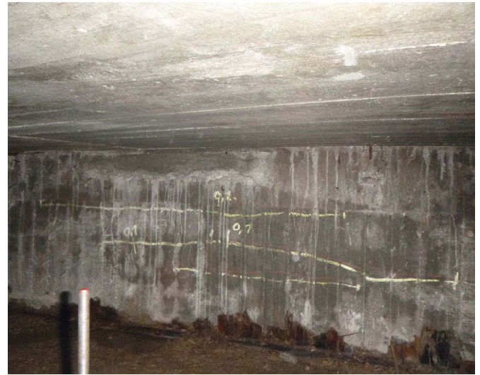
Bild 4 Rissverlauf im Längsträgersteg mit Angabe der Rissbreite Crack course in web of girder
