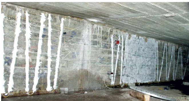
Bild 7 Markierter Verlauf der Risse und hohl liegenden Bereiche bei Abschluss des Versuchs an der Messstelle MI sowie Darstellung der Messtechnik Crack course in web of girder at test point MI after end of test
